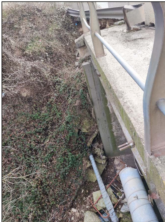
Foto 09 – Zona afectada pel despreniment, al trasdós de l'estrep aigües amunt, costat est. Vista de la protecció amb escullera actual.
