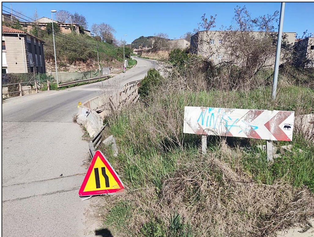
Foto 10 – Zona on es preveu la reposició del tram de barrera i panell d'abalisament.
