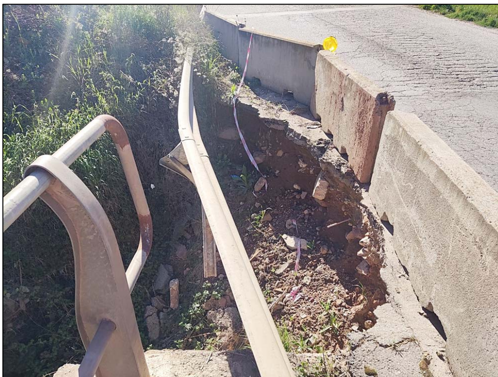
Foto 07 – Zona afectada pel despreniment, al trasdós de l'estrep aigües amunt, costat est.
