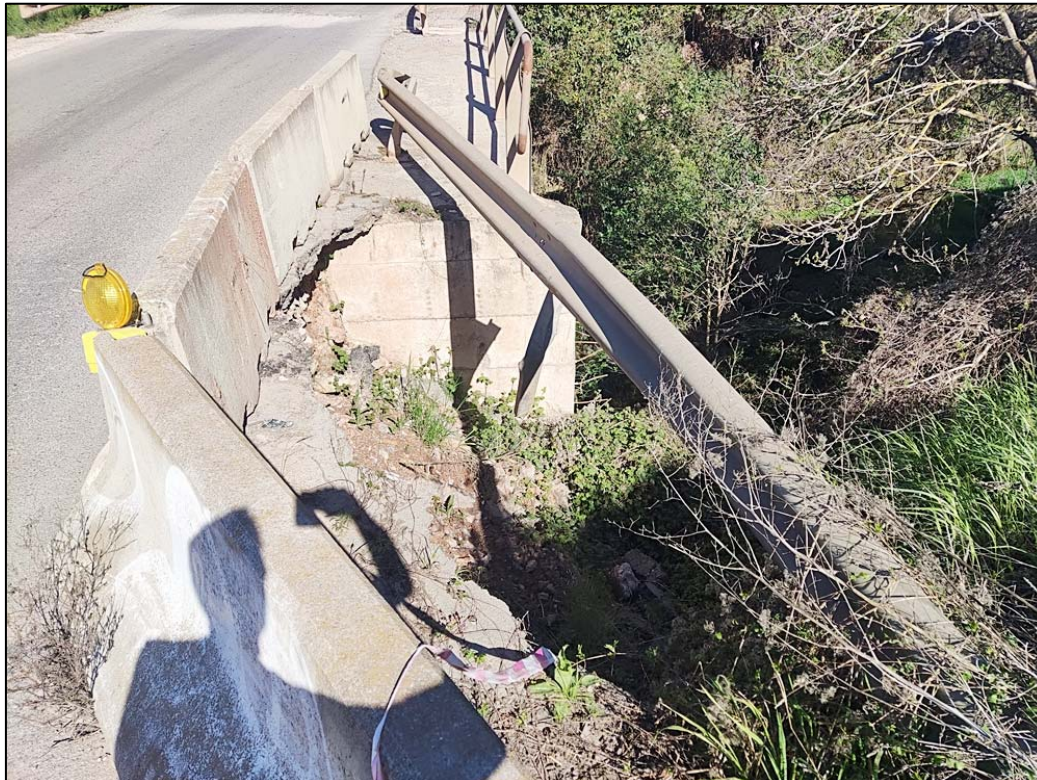
Foto 06 – Zona afectada pel desprendiment, al trasdós de l'estrep aigües amunt, costat est.
