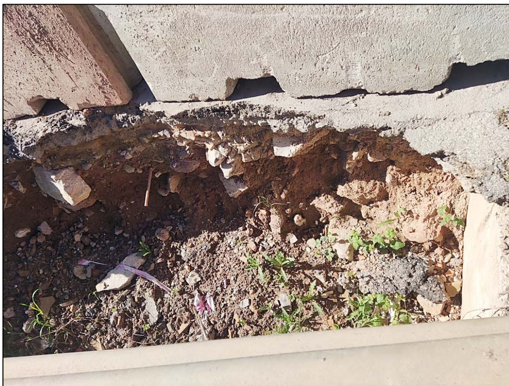
Foto 08 – Zona afectada pel despreniment, al trasdós de l'estrep aigües amunt, costat est.
