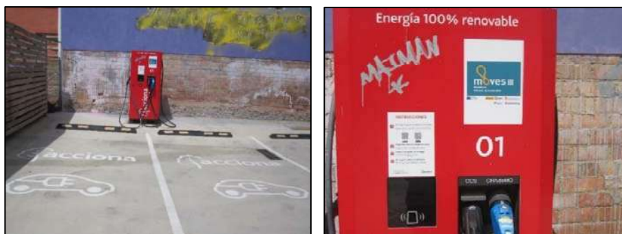
Dues places reservades a recàrrega elèctrica a l'aparcament de Les Faixes
