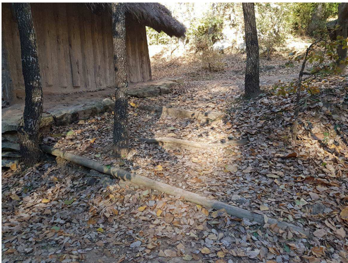
Imatge 11: escales de fusta a reparar
