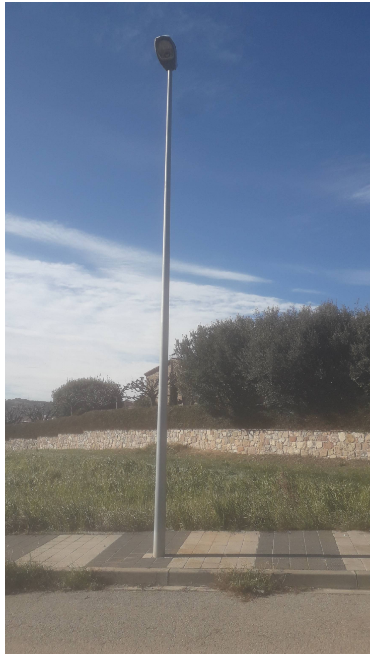
Vista dels serveis existents, enllumenat, aigua, electricitat
