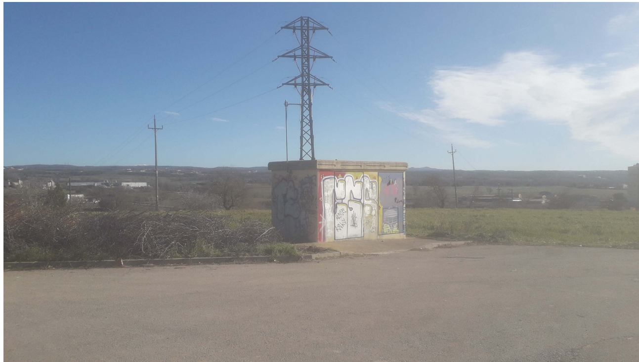
Vista del centre transformador existent a la cruïlla dels carrers Mercè Rodoreda i Avinguda del Jo
